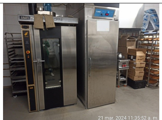
Foto No. 6. Cámara de crecimiento y horno (panadería)
