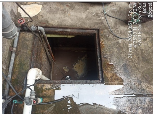
Foto No. 10. Tanque homogeneizador
