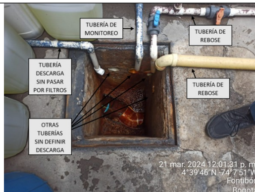
Foto No. 13. Caja de inspección interna
