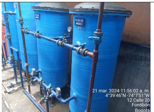
Foto No. 12. Filtros
