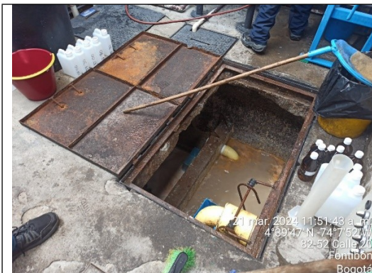
Foto No. 9. Trampa de grasas
