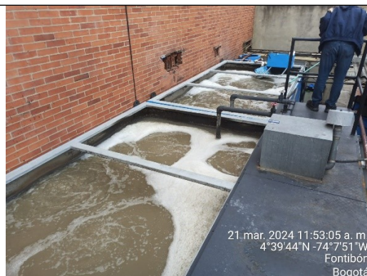
Foto No. 11. Unidades de tratamiento
